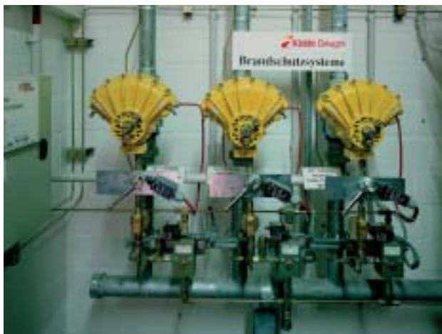
Sekční ventily vysokotlakých hasicích zařízení
