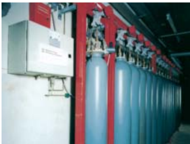
Vysokotlaké zařízení CO 2 s pneumatickým zpožďovacím zařízením
